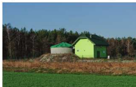
Oczyszczalnia ścieków w Łękawie
